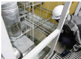
天井裏の構造を模した設備も完備
